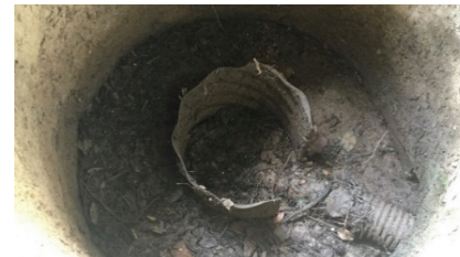
24 Sediment in Riser
